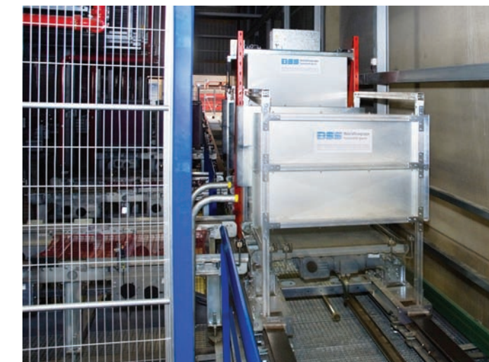
Die Verteilung der Paletten auf die einzelnen HRL-Gassen erfolgt durch den QVW.
