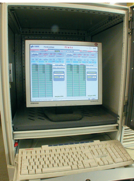
◀ Die Anlagenvisualisierung (WinCC) gibt Auskunft über den Stand aller Aufträge und erlaubt die Abänderung vorgegebener Routinen.
